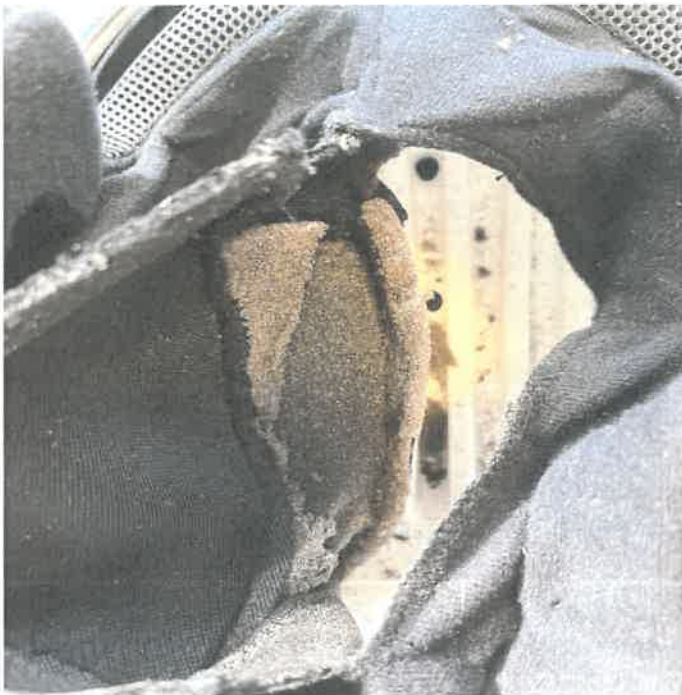
Fotografia detall deteriorament Poliestirens expandiu
